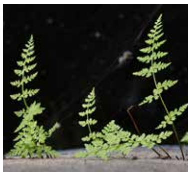
Stenbräken växer i murverket vid Fattighusån.
